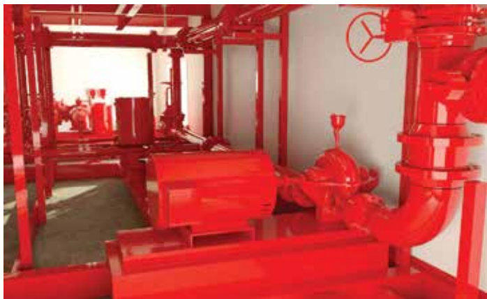
VISTA INTERIOR DE CASETA DE BOMBEO
