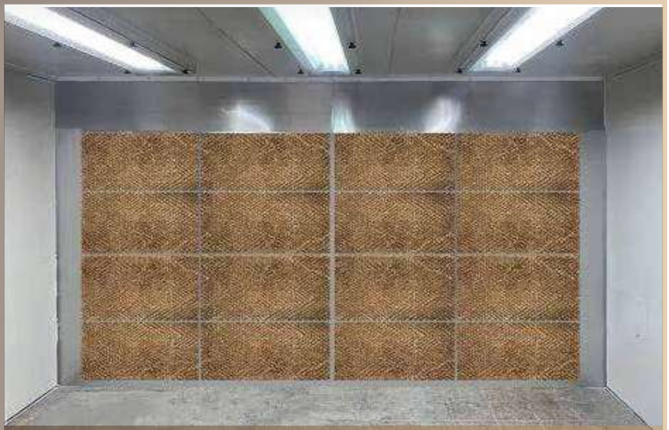
Filtracion de pared
